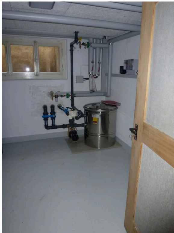
Technikraum 10 m2: Filteranlage für das Schwimmbad (von 2016).
