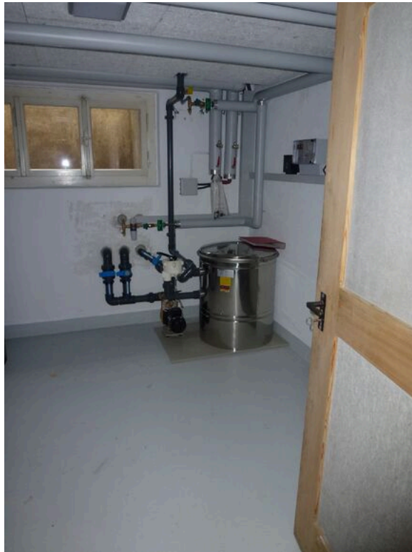
Technikraum 10 m2: Filteranlage für das Schwimmbad (von 2016).
