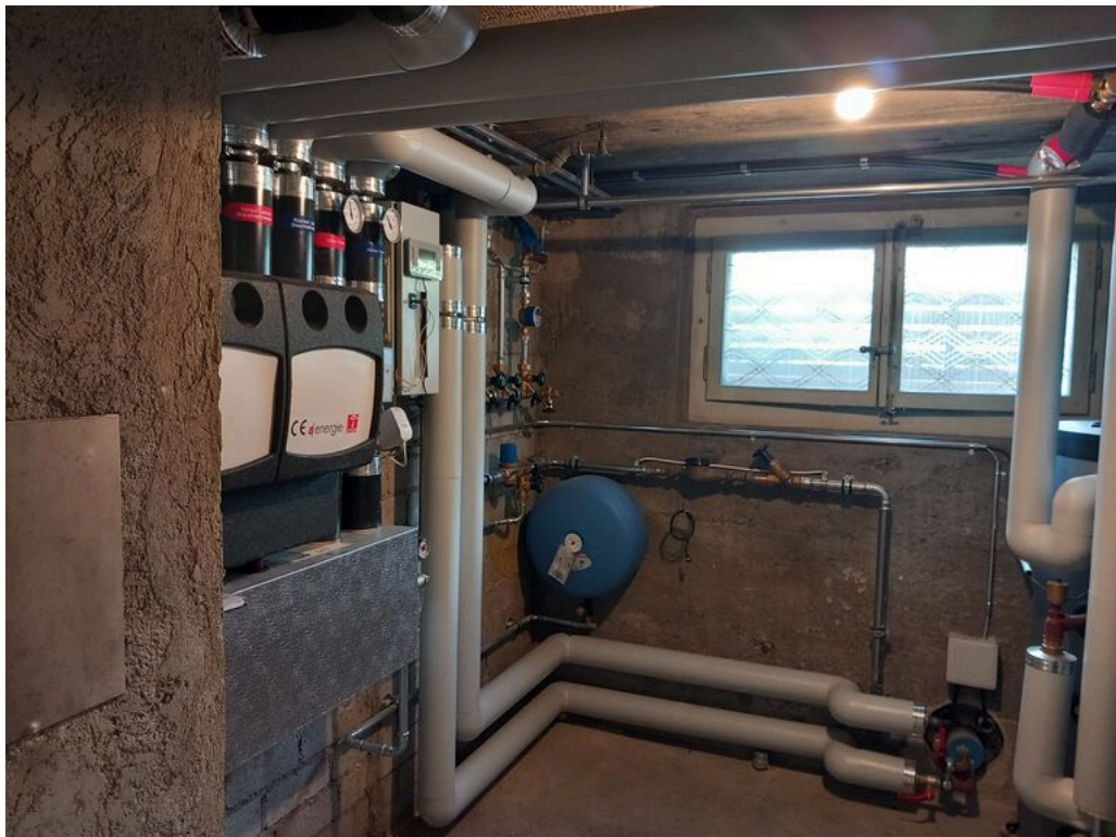
Heizung und Warmwasser von 2022.
